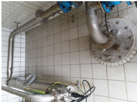
Bohrbrunnen und UV-Desinfektionsanlage
